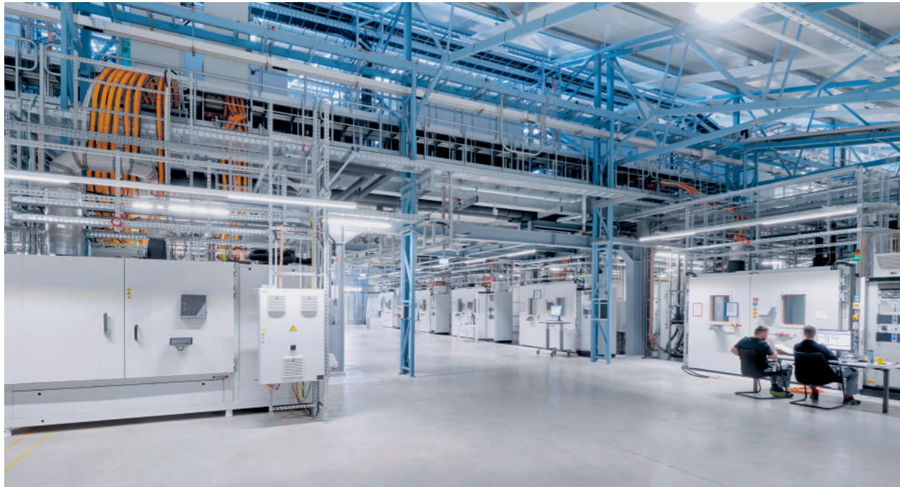
Bereit für große Aufgaben: Lithium-Ionen-Batterieprüffeld mit 59 Prüfanlagen
