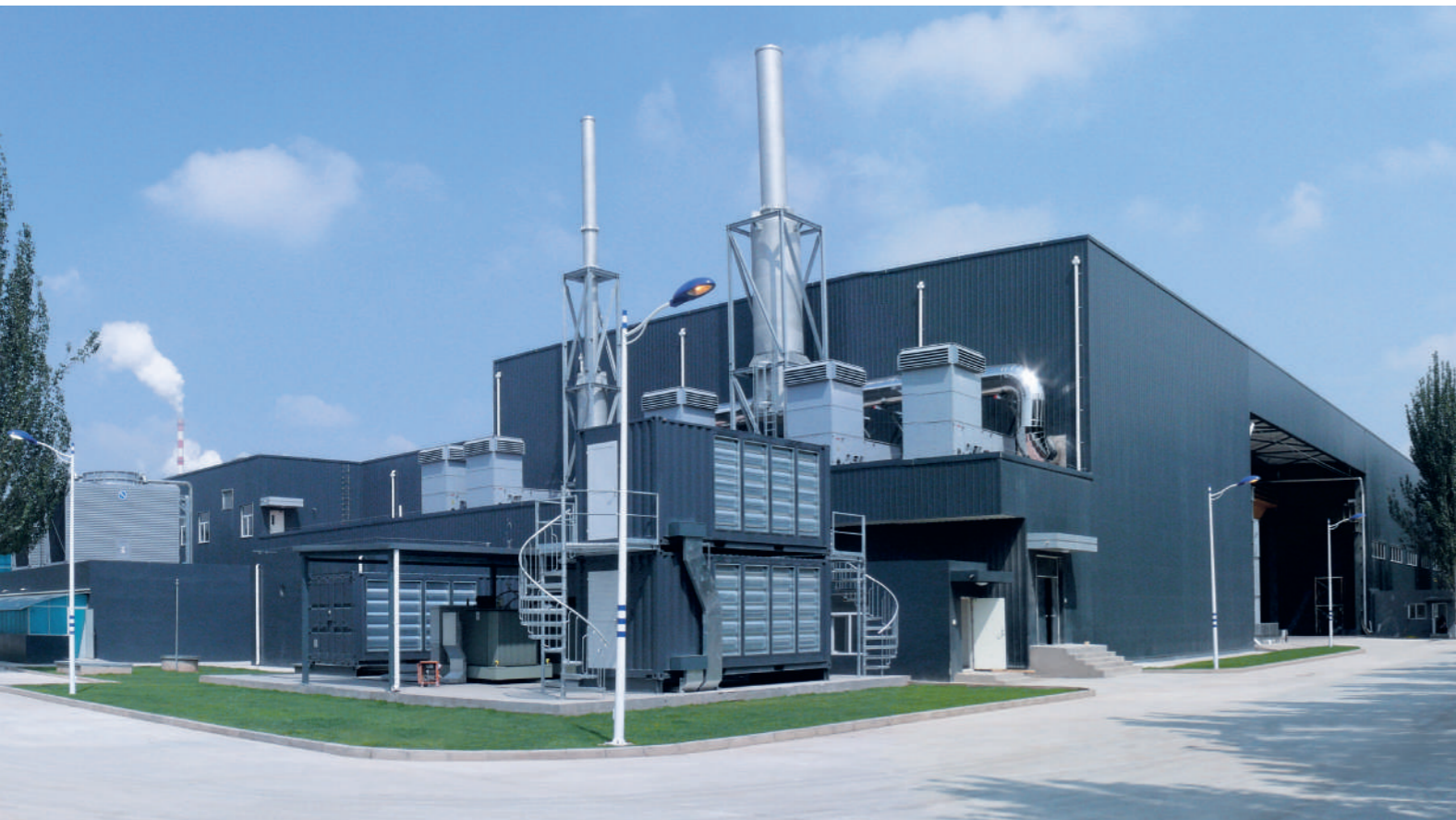
Komplettes Großmotorenprüffeld, von ROM als Generalunternehmer realisiert
